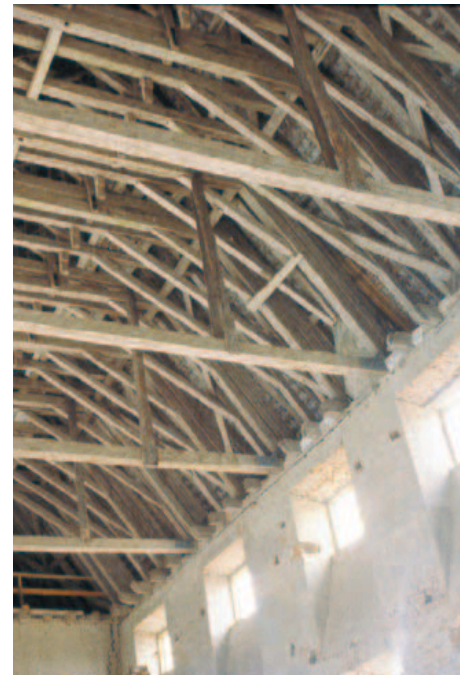
De horisontella bjälkarna i höjd med murkrönen är bärverket till en tillfällig byggnadsställning som skulle ha använts för att göra det stucktak som aldrig blev utfört.
