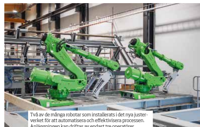
Virke transporteras genom det nya justerverket för slutkapning och paketering innan det levereras vidare ut till kund. Anläggningen är en av världens mest produktiva.
